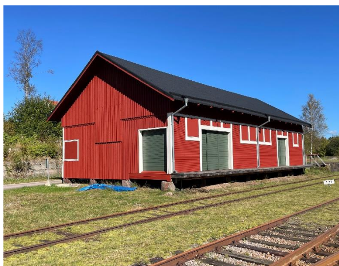
Godsmagasinet har blivit ännu finare under 2025. Bl a har delar av portarna fått nytt trä och målats gröna.
